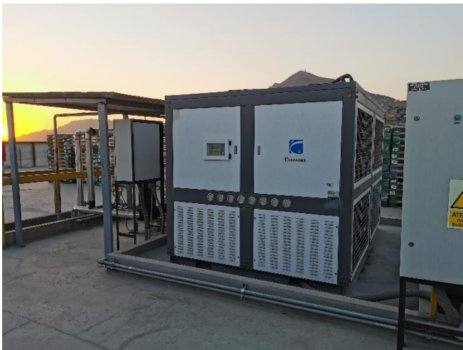
Figura 27. Nuevo equipo chiller destinado al uso exclusivo de la sección de líquidos no estériles. Fuente: Elaboración propia.
