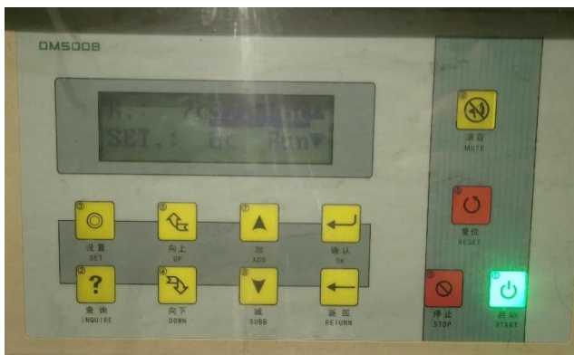
Figura 30. Panel de control del equipo INDUSTRIAL CHILLER Model CA-60F marca COOLSOON. Set point de temperatura de trabajo: 6°C. Fuente: Elaboración propia.
