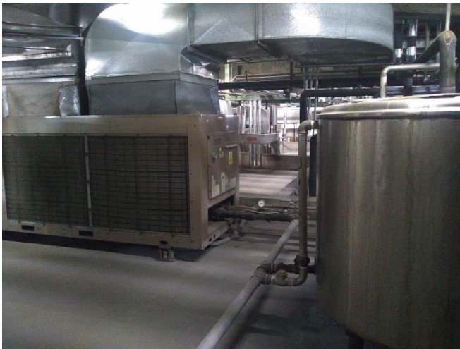
Figura 26. Antiguo equipo chiller destinado al uso compartido de la sección de líquidos no estériles y la sección con máquina formadoras de frascos. Fuente: Elaboración propia.
