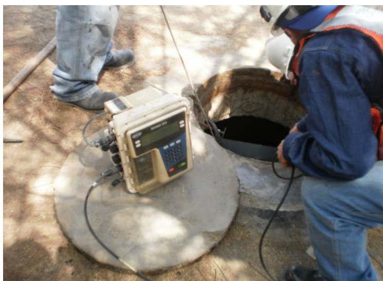
Foto N° 4.1: Instalación de medidor en buzón (altura Panamericana Norte – Esquema Sureños)
